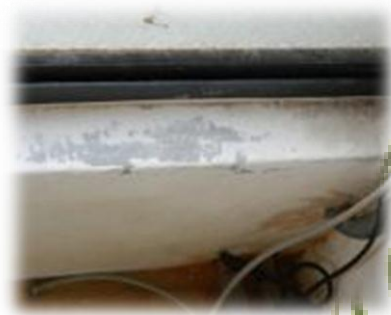
施作前，圖書室牆壁壁癌嚴重 (施作前)
